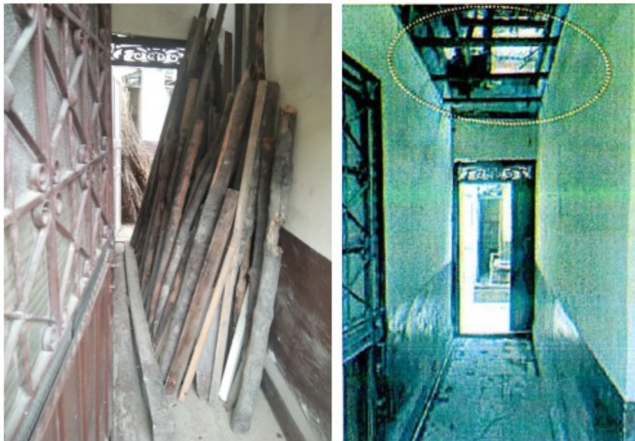
Fotografías del estado actual del zaguán, a partir de las imágenes tomadas del documento presentado por el propietario.
