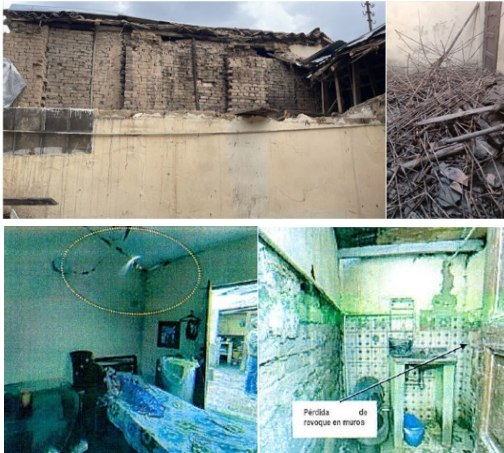
Fotografías del estado actual de las habitaciones y el baño a partir de las imágenes tomadas del documento presentado por el propietario
