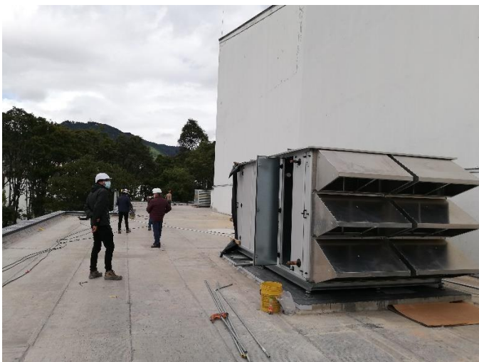
Fuente: Visita León de Greiff, julio 29 de 2022. Equipos sistema de aire acondicionado.
